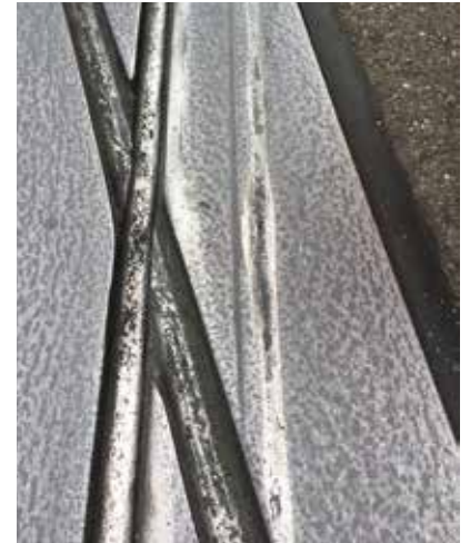
Ein typisches Schadensbild (senkrechter Streifen rechts).
