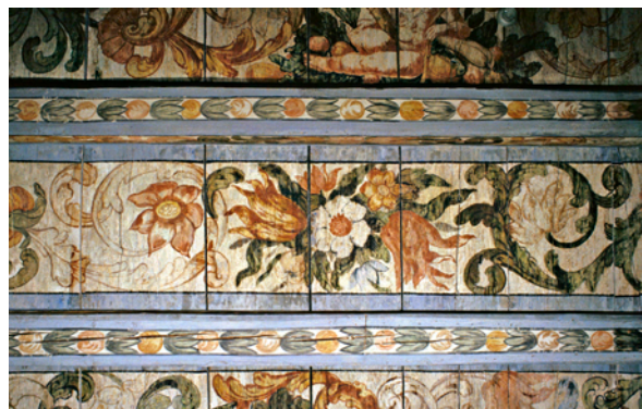
Diese Deckenmalerei an der Unteren Rheingasse 10 wurde dank der Bauforschung der Denkmalpflege 1985 entdeckt und vor der Zerstörung bewahrt.
