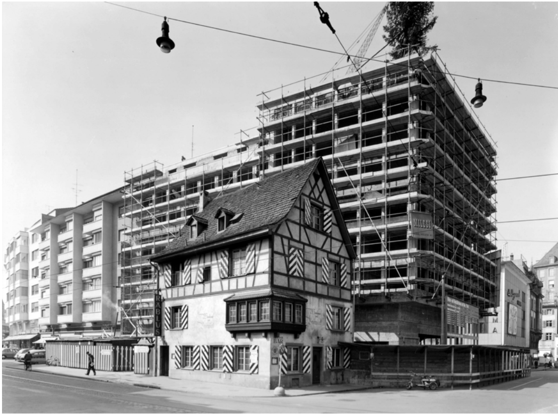
Die Steinenvorstadt wurde in den 1960er Jahren radikal verändert und neu gebaut. Der Autoverkehr sollte ungehindert in die Innenstadt geführt werden können. Hier die Steinentorstrasse 6 kurz vor dem Abbruch.
