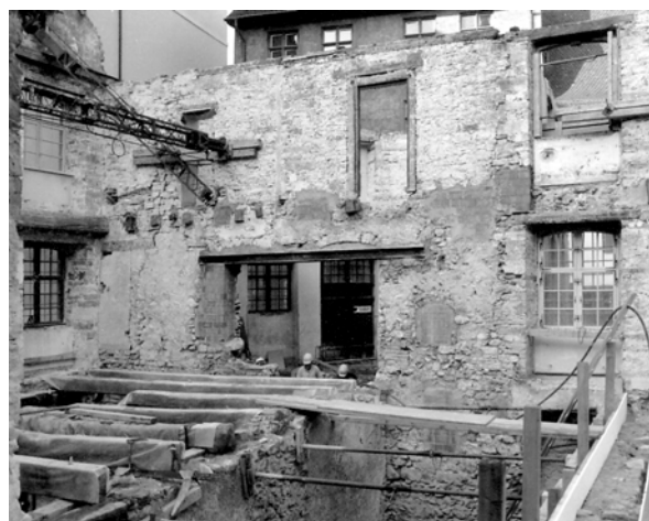
Auskernung eines Hauses an der Martinsgasse 13 (1982). Historische Baudenkmäler bestehen nicht nur aus Fassaden, sondern aus einer Raumabfolge und oft wertvollen Ausstattungselementen wie Täfer, Stuckdecken, Parkett, Wandmalereien. Ein Haus ohne Innenleben hat nur noch einen geringen historischen Zeugniswert.
