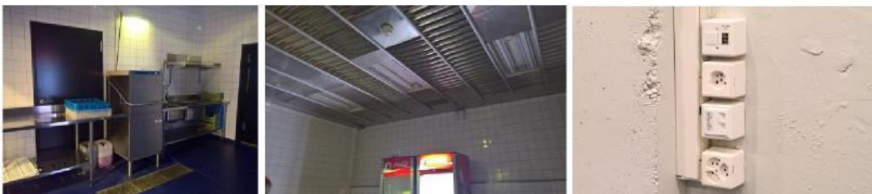
Abb. 77-79: Aufbereitungs-Küche, Lüftung an Decke, Stromanschlüsse
