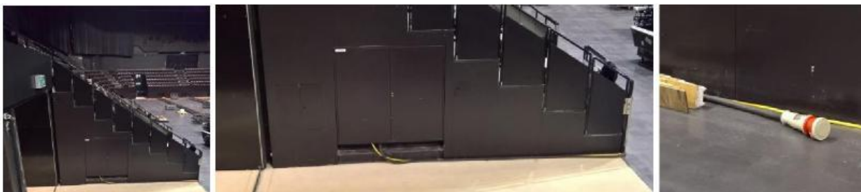
Abb. 62–64: Elektroverteilkasten LKW-Einfahrt Nord, Kabel (noch nicht mit Stolperfalle gesichert)
