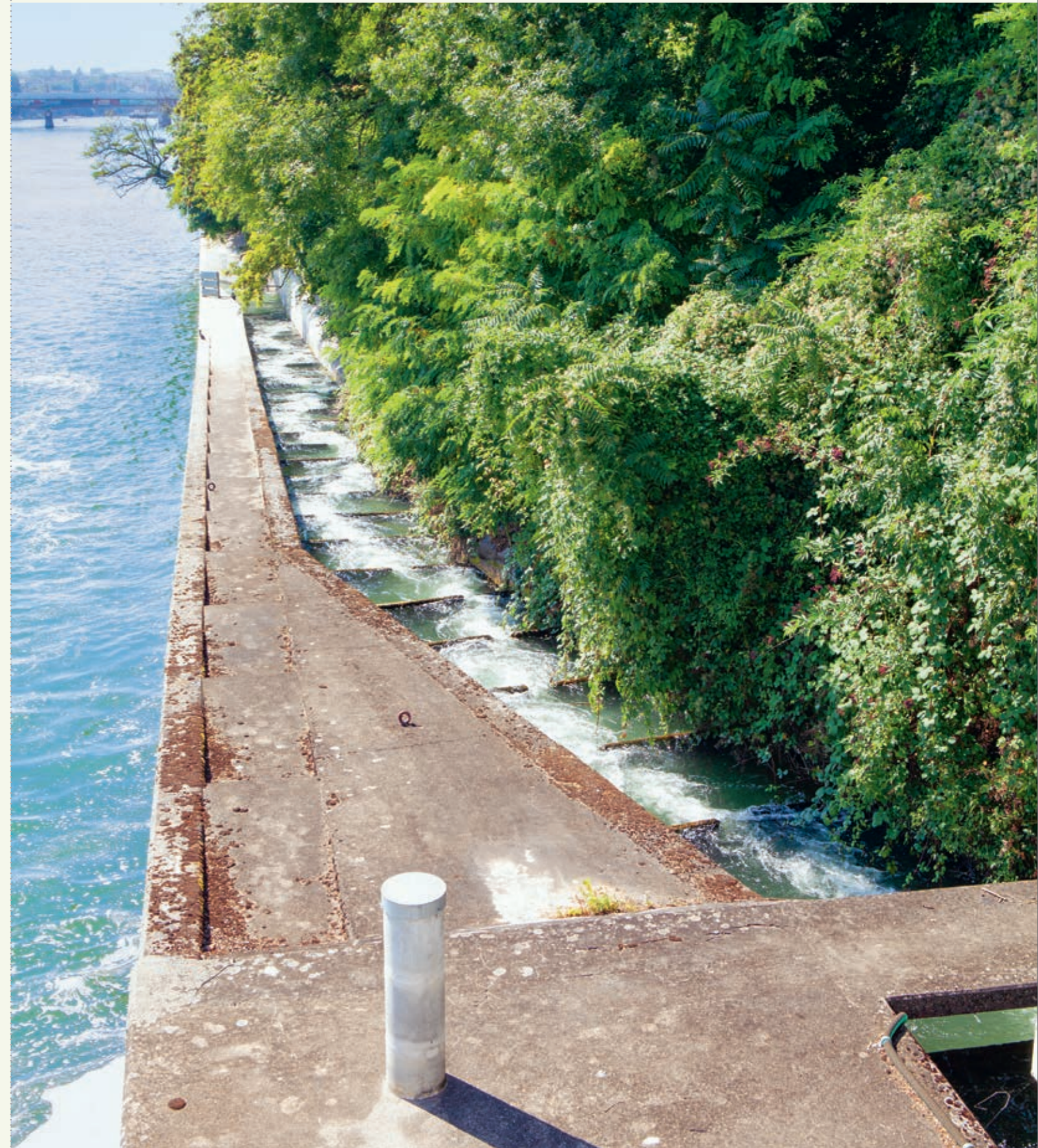
Die Fischtrappe beim Kraftwerk Birsfelden soll saniert werden. – Foto: Christopher Gmuender
